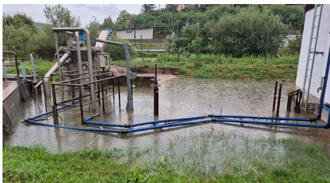
Částečně zaplavená ČOV Bilovice
